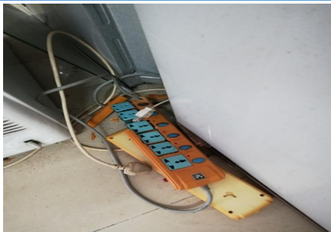
使用严重破损的插线板
